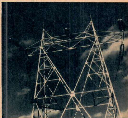
Kraften från Järpströmmen transporteras till mellersta och södra Sverige på 200 kV-ledningar.
