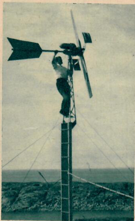
En 1.000 watts vindgenerator på Vinga. Chefen för den här förlagda marina avdelningen, styrman Bredenfält, har klättrat upp för den 15 meter höga, stabila och medelst järndubbar i klippan väl stagade masten för att utföra en justering på generatoren. I bakgrunden kan man — åtminstone i verkligheten — skåda Carlstens fästning i Marstrand.
