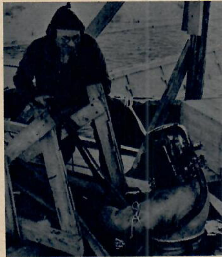
Nere vid stranden jobbar en dykare med en stor kaj och kylvattnets in- och utloppsledningar.
