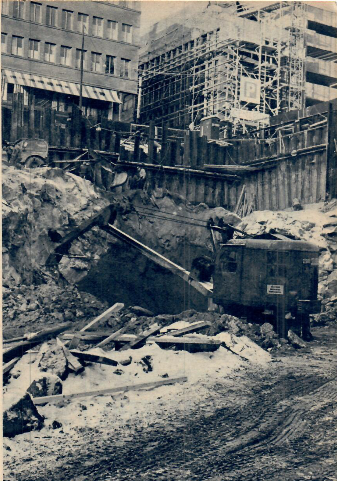
Grävskopor och truckar har haft ett hårt arbete med att schakta bort de 80 000 kubikmeterna för grunden.
