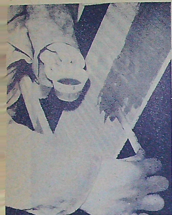
1 Skarvlapparna, som tjänar som underlag för skarvarna mellan plywoodborden, fälls in i vägarna och skruvas fast. Här stryks limmet ut på en skarvlappshalva.
