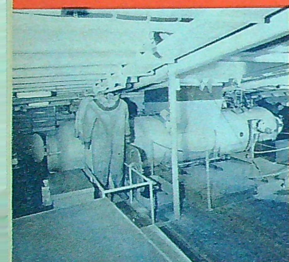
I dykrummet finns bl a fem tunga och fem lätta dykutrustningar, syrgas- och heliumpumpar etc. I bakgrunden skimtar rekompresjonskammaren.
